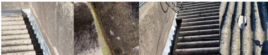
Imagem 01: Patologias identificadas em telhas, calhas e cumeeiras.
